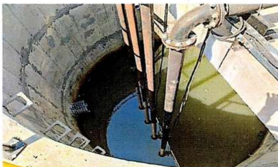
Plate: 5 : Effluent collection chamber
